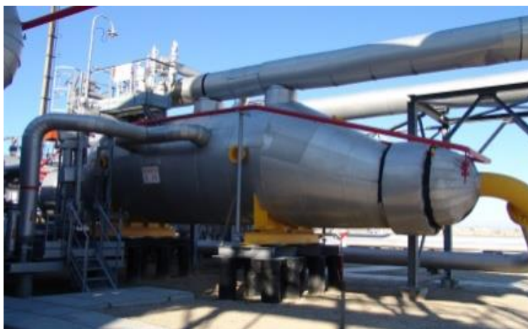
Фото. Общий вид теплообменника-испарителя АВО газа
